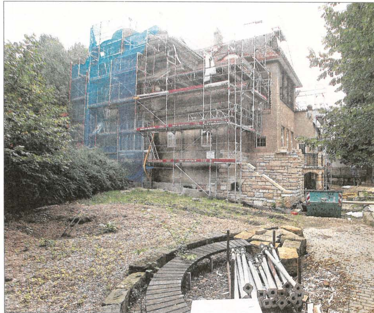
Nachdem bei der Sanierung der Kindertagesstätte ein altes Treppenhaus wiederentdeckt worden ist, muss im Garten kein Treppenturm als Fluchtweg gebaut werden. Er sollte ans Haus angedockt werden. Foto: Rudel
